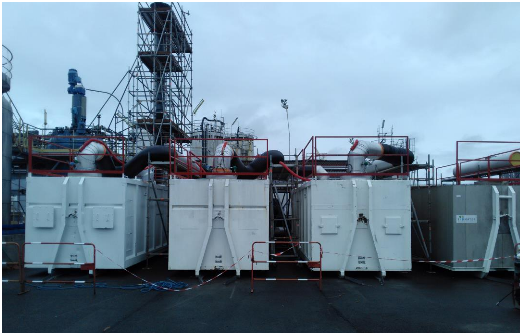
Caissons charbon actif
